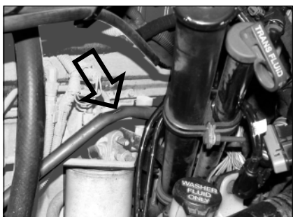
Muestra de una tubería de descarga dañada.
